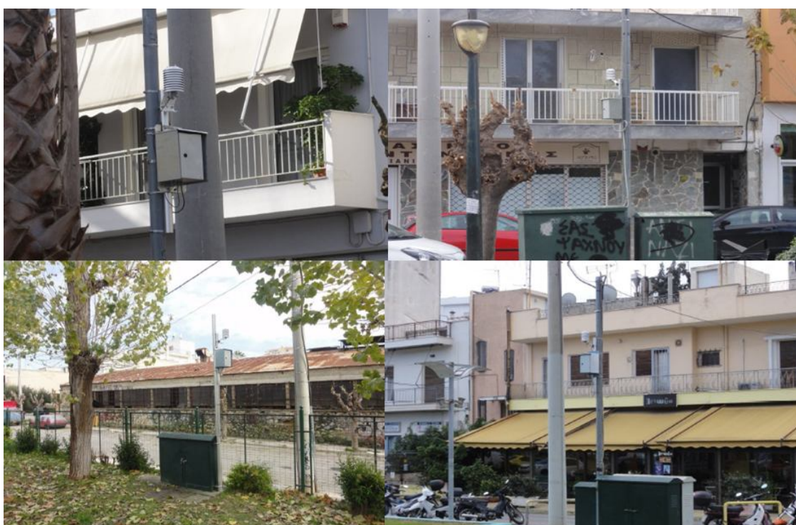
Φωτογραφίες εγκατάστασης των on-line αισθητήρων
