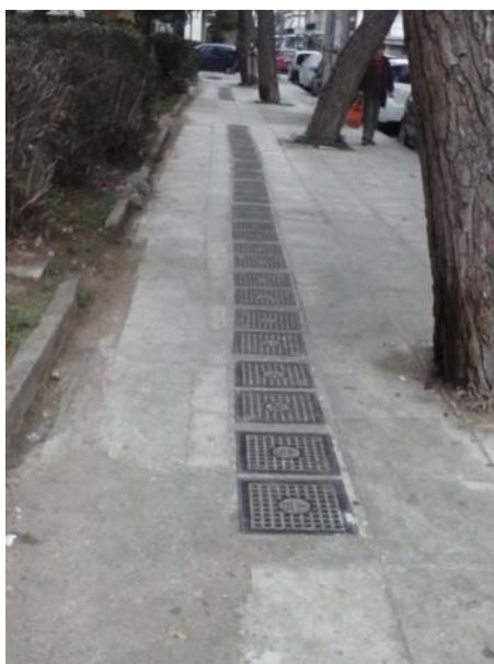
Πεζοδρόμιο επί της οδού Αισώπου (από χώρο στάθμευσης έως Μαδύτου)
